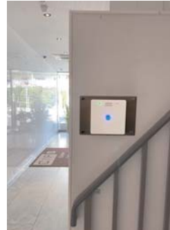
1階 入口前 カードリーダー
